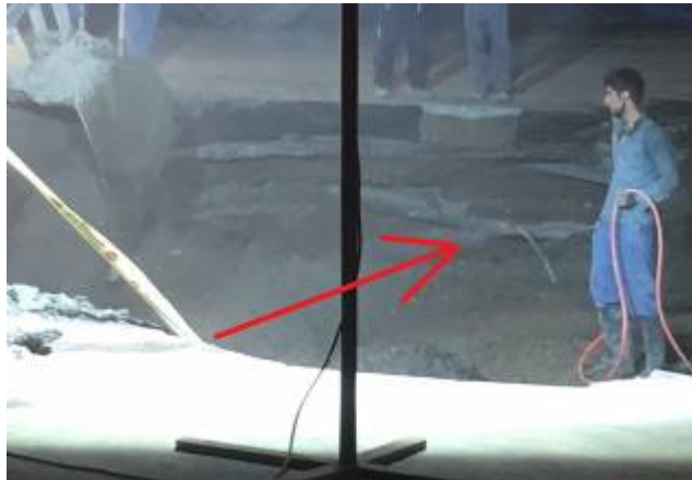
شکل ۴-۵- لوله‌های موجود در گود ایجاد شده محل حادثه
