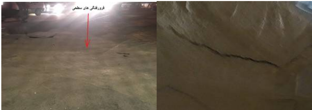
شکل ۴-۲- تصویر از فرو رفتگی و ترک های ایجاد شده محل در بازدید میدانی
