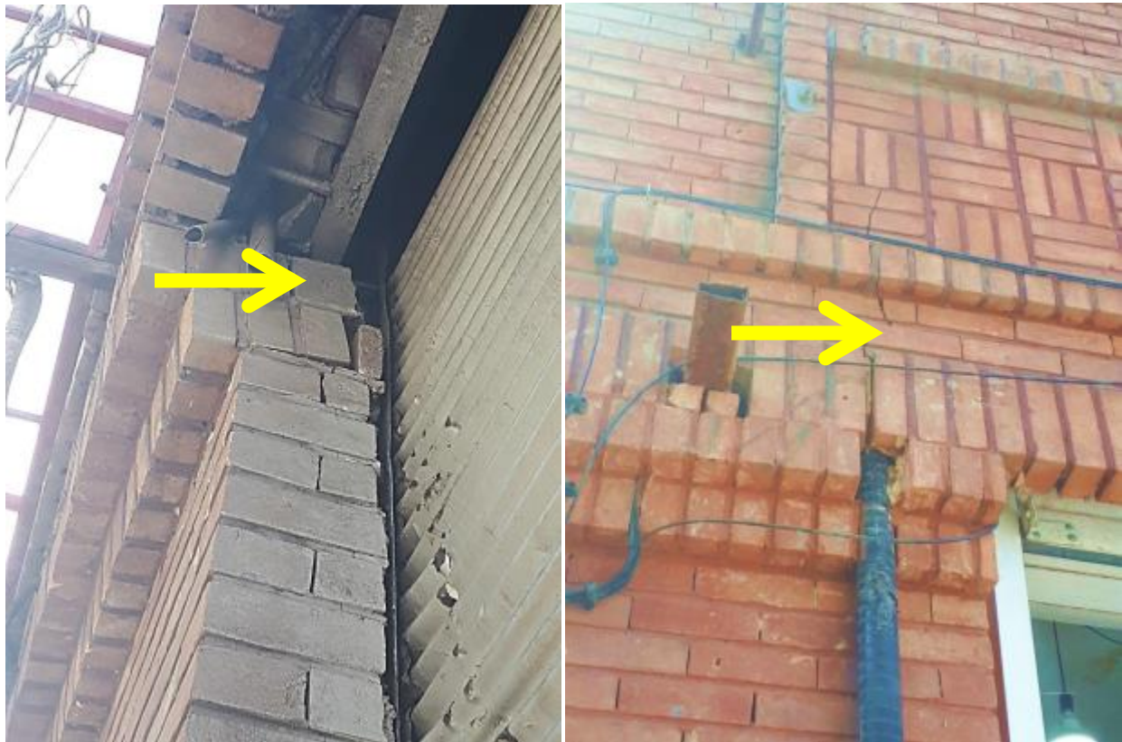
شکل ۱۱- بروز ترک و جدایی در ساختمان‌های مجاور محل ایجاد حفره
