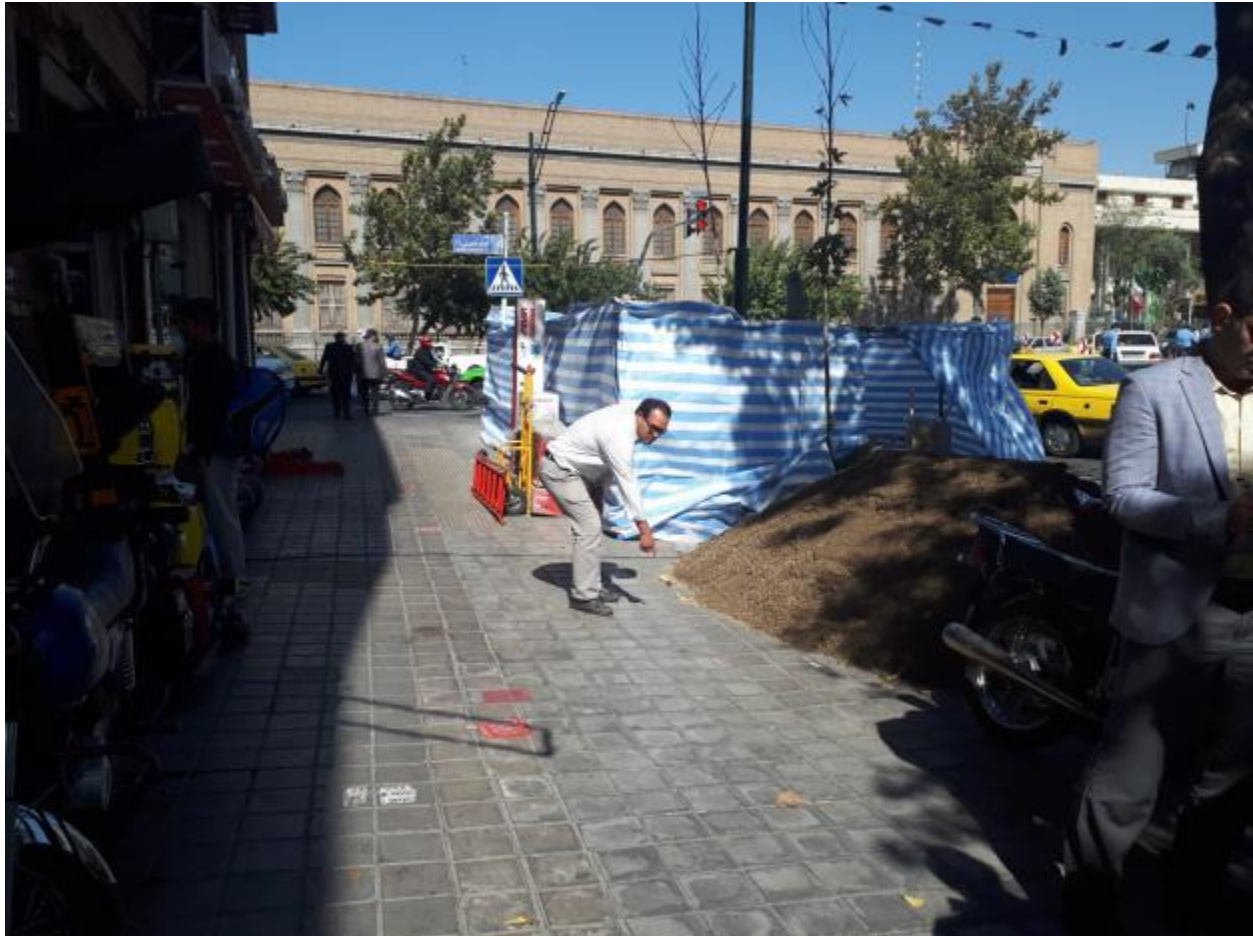
شکل ۷- گودرفتگی قدیمی موجود در پیاده رو مجاور حفره ایجاد شده
