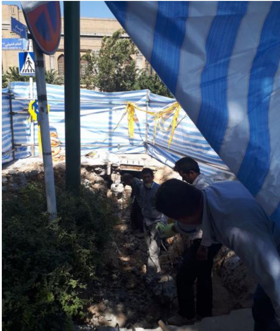
شکل ۴- حفره ایجاد شده در تقاطع خیابان امام خمینی (ره) و خیام
