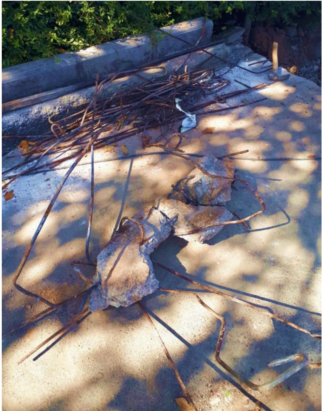
شکل ۹- بخشی از جداره کانال انتقال آب زیرسطحی در محل حفره ایجاد شده
