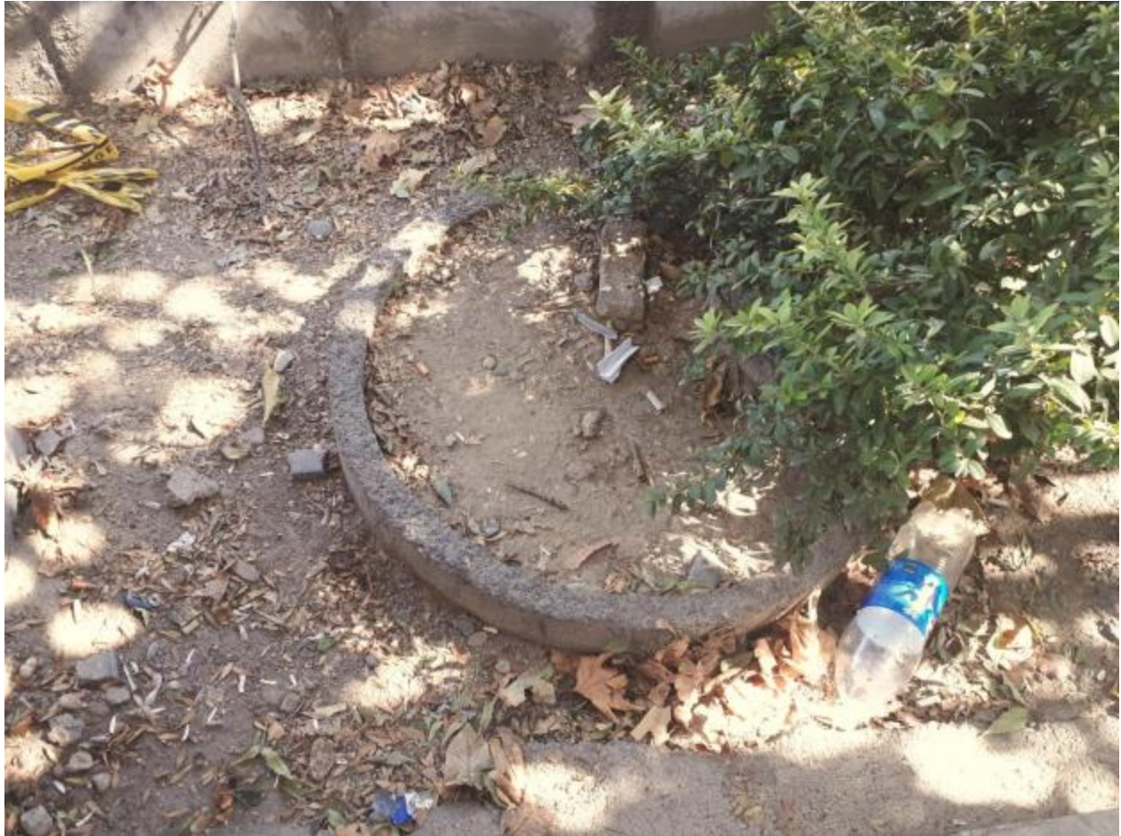
شکل ۱۲- دریچه ورودی چاهک های متصل به خط مترو در منطقه (در مجاورت حفره ایجاد شده)
