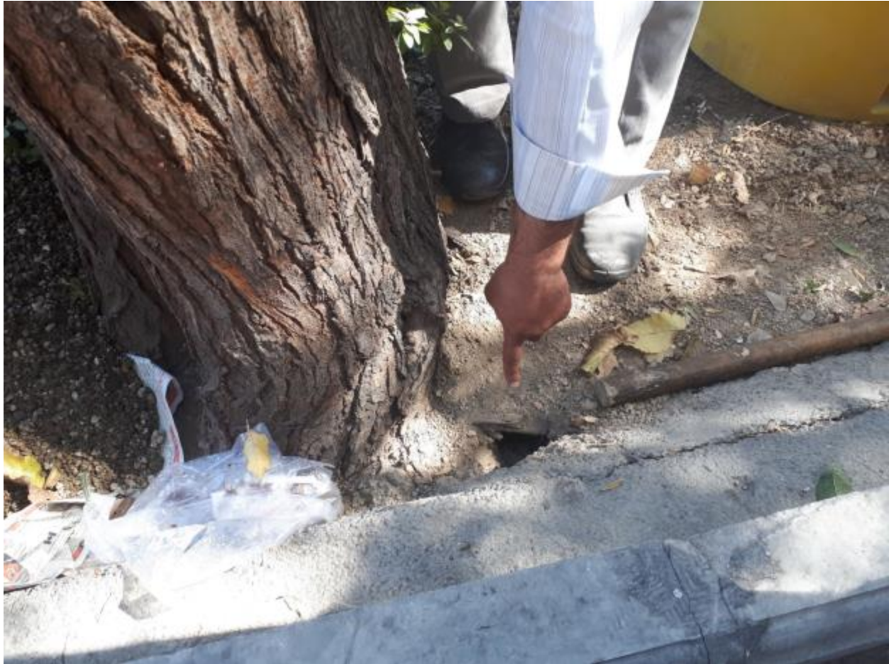
شکل ۸- وجود حفره در خاک ناحیه مجاور محل فروریزش
