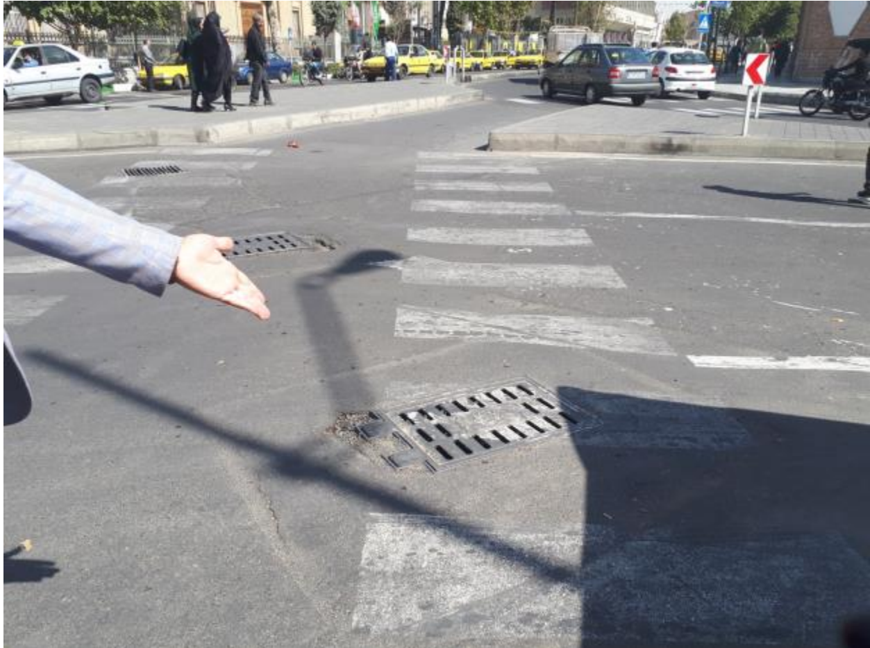
شکل ۵- کانال آب زیرسطحی منتهی به حفره ایجاد شده
