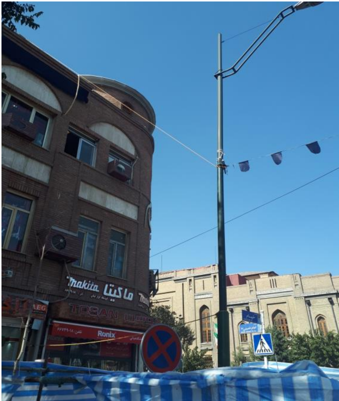
شکل ۱۰- عدم تعادل تیرچراغ برق مجاور حفرة و مهار کردن آن با طناب برای جلوگیری از سقوط
