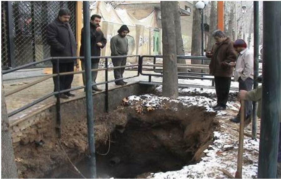
شکل ۶-۵- ریزش قنات و نمود ظاهری آن در سطح زمین
