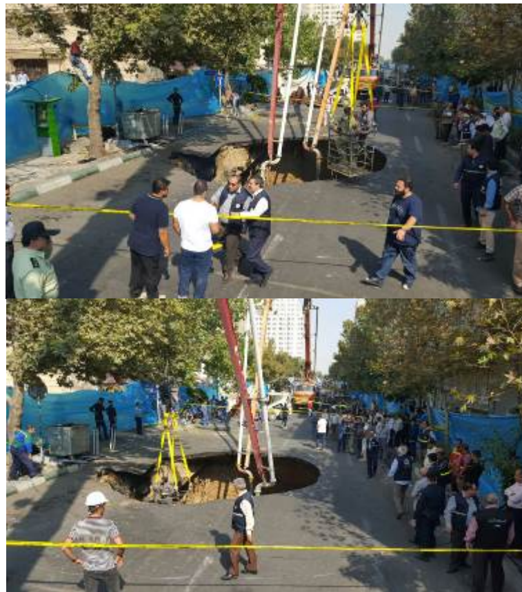
شکل ۸-۱- بازدیدهای کارشناسی از وضعیت لوله‌های تحت تاثیر فروریزش در حفره
